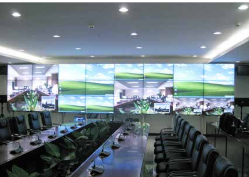
深圳龙岗大运村科技楼会议系统
